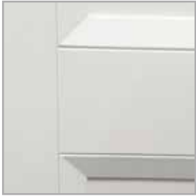
faza na łączeniu ramiaków
